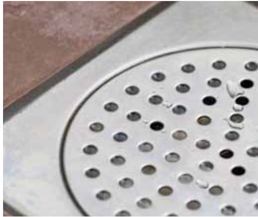
Otättheter vid golvbrunnar är ett vanligt problemområde.
